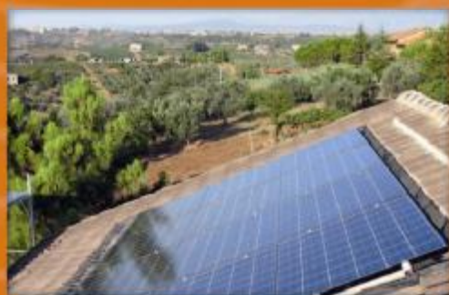
Impianto da 2,1 kWp Architettonicamente Integrato Vasto (CH)
