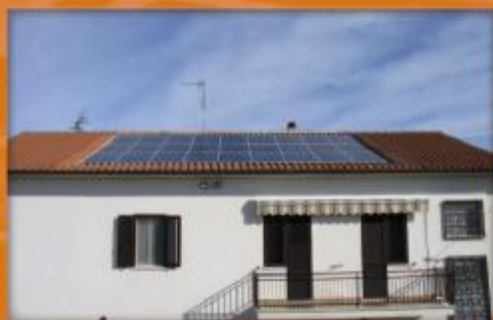
Impianto da 5,96 kWp Architettonicamente Integrato Vasto (CH)
