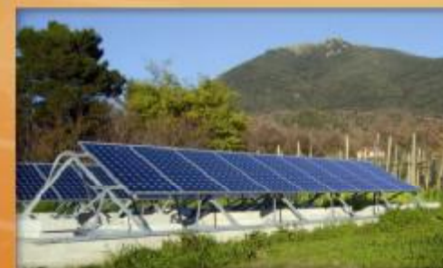
Impianto da 3 kWp Architettonicamente Non Integrato Portofino (CE)
